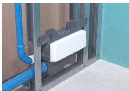
Aplicação em calha técnica
